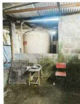
Foto 4: La cocina no cuenta con ventana.
