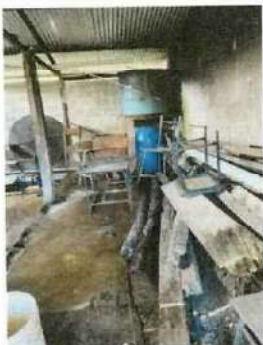
Foto 3: El piso de torta de concreto presenta grietas por humedad.
