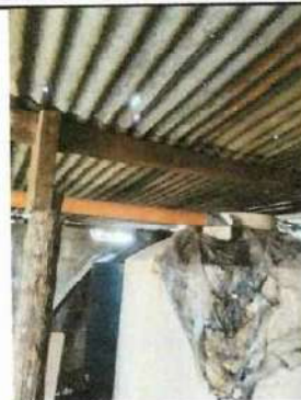
Foto 2: Las vigas de madera ya presentan humedad.
