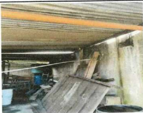
Foto 1: Cocina con filtración de agua por deterioro de laminas.
